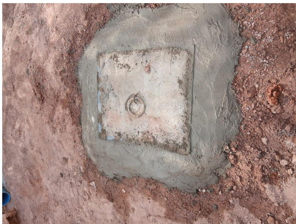
Vue de la protection du forage équipé
