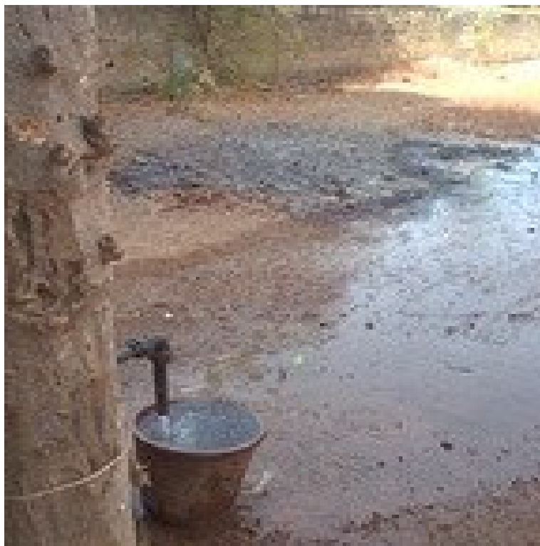
Vue de robinet ouvert à l'école pour essai
